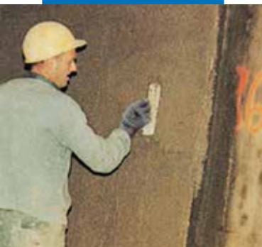
Использование цементной штукатурки с добавлением Planicrete в строительстве автодорожного туннеля в Виль-Мари, Монреаль, Канада
